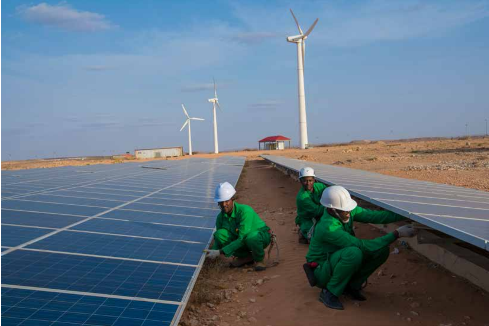
Vind og solcelleanlegg i Garowe, Puntland i Somalia. Tidligere pirater har fått yrkesopplæring som elektrikere, og jobber nå med å drifte anlegget. Foto: Håvard Bjelland/Kirkens Nødhjelp
