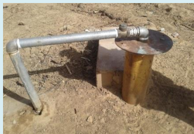
Photo 7 : Connexion château PMH, Déc. 2019
